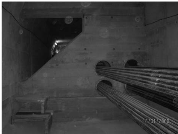
Figura 30. Vista del pretensado exterior dentro del cajón atravesando un diafragma dispuesto para limitar la distorsión del tablero.
